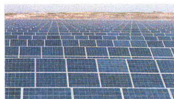
Huerto solar proyectado por la empresa Parques Solares de Navarra
